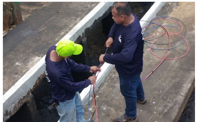
Conexión de Sistema Eléctrico para Hidro lavadora en el Departamento de Engrase en Zona B - Carrasquilla
