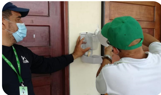
instalación de dispensadores de gel alcoholado para cumplir con las medidas de sanidad, para hacerle frente al covid-19.
